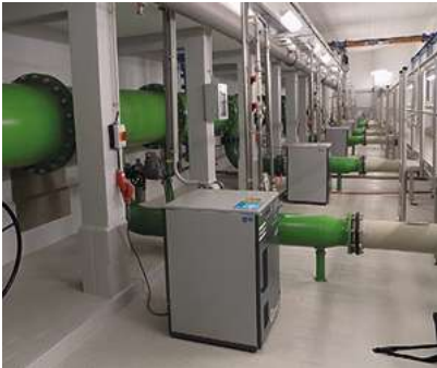
Wasserwerk Bürstadt - Belüftungsanlage
